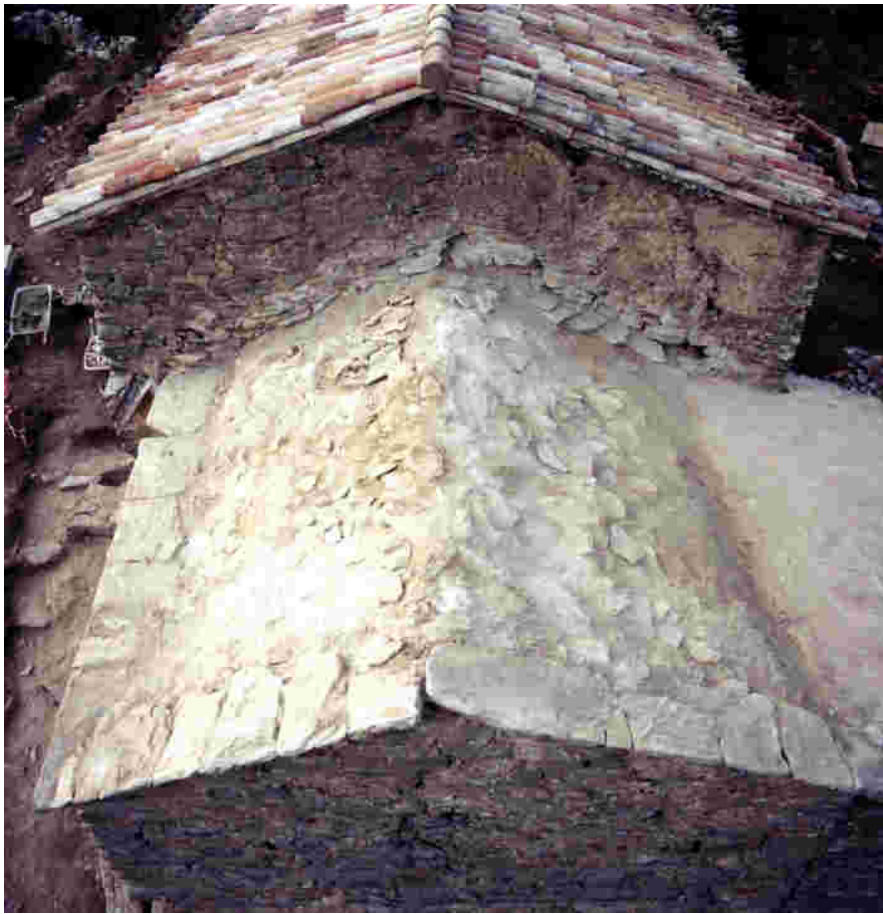
28. Teulada de la capçalera de Sant Pere de Serrallonga un cop finalitzada l'excavació arqueològica. Arxiu fotogràfic de l'SPAL, núm. clixé 161.232.
